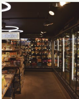
Panasonic réfrigère Le Carrefour City de La Madeleine. Première installation de 2 unités de condensation au CO 2 de 15 KW. CO 2
